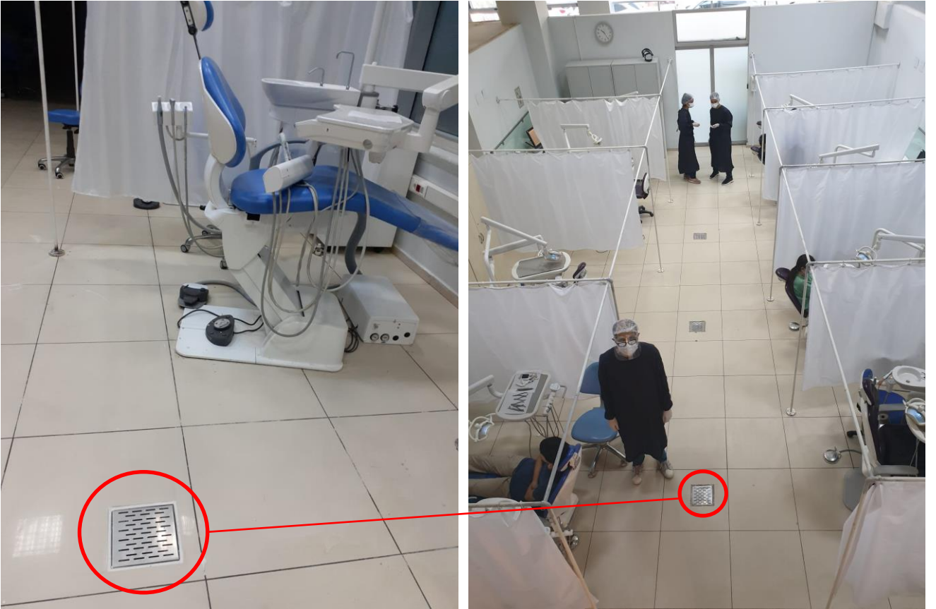
Şekil 11.10: İKÇÜ Diş Hekimliği Fakültesi polikliniklerinde izolasyon önlüklü sağlık personeli, ünitler arası izolasyon perdeleri ve zeminde yer alan kirli hava tahliye sistemi görülmektedir.
